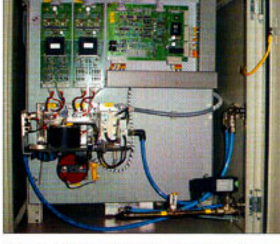
Bild 2: 10 kW Induktionserwärmungsumrichter, Innenansicht Fig. 2: Inside of 10 kW induction heating converter
