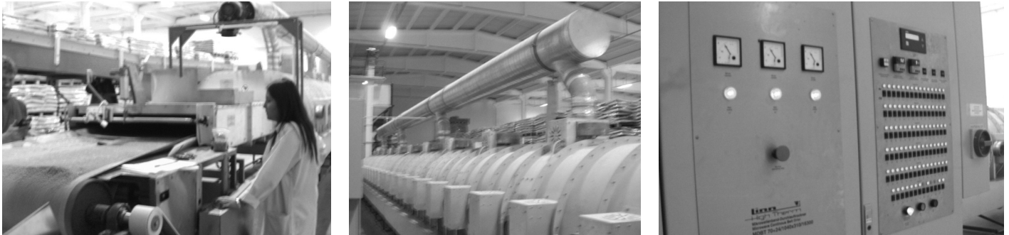
Bild 4 Mikrowellen-Banddurchlaufrockner MDBT 70+24/1040/210/16300 von LINN HIGH THERM in der Produktion (installierte Mikrowellenleistung 70 kW, Heißluftleistung 24 kW, Durchsatz ca. 2000–3000 kg/h)
